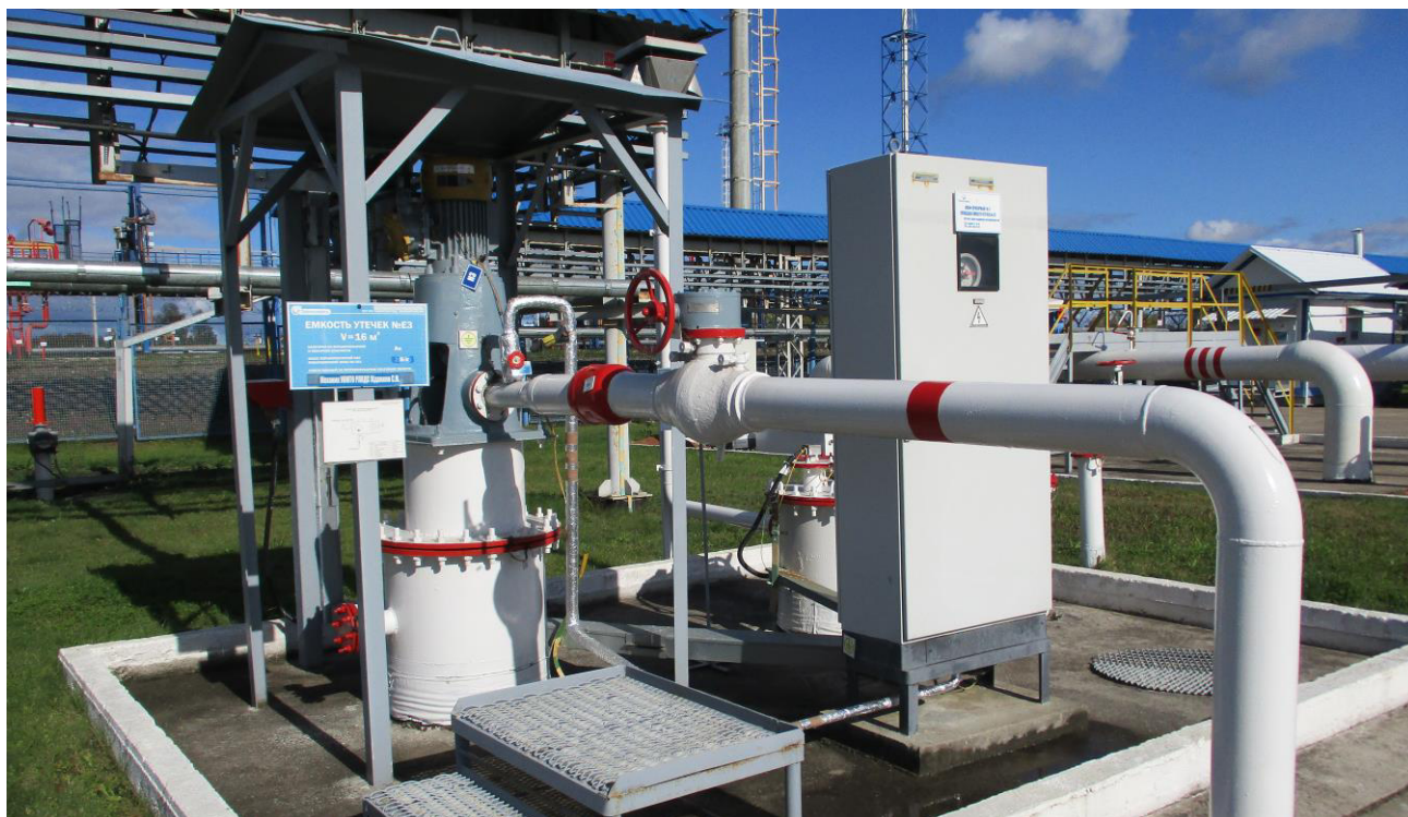
Рисунок 3 – Горловины и измерительный люк резервуара Пломбирование резервуара ЕП 16-2000-1300-2 не предусмотрено.
