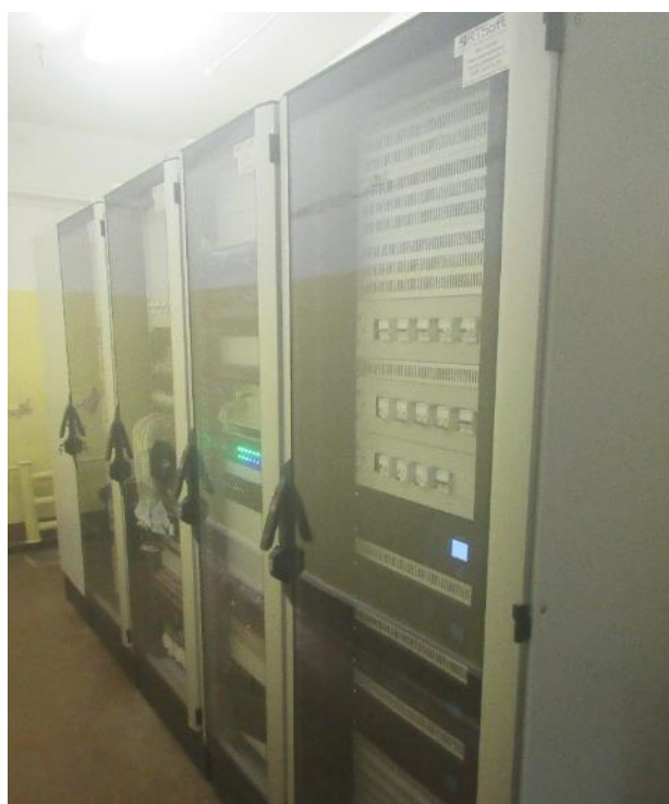
Рисунок 4 – Общий вид станции сбора данных стенового комплекса СК 12 ИВК Персей
