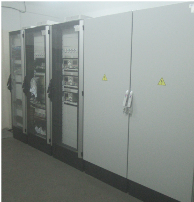
Рисунок 9 – Общий вид станции сбора данных и шкафа кроссового станда 112А ИВК Персей
