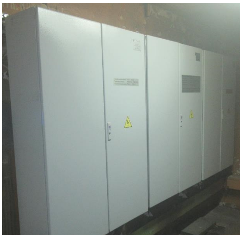
Рисунок 6 – Общий вид шкафов датчиков стандового комплекса СК 12 станда 12А ИВК Персей
