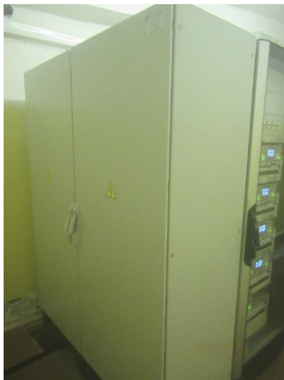
Рисунок 5 – Общий вид шкафа кроссового стандового комплекса СК 12 ИВК Персей
