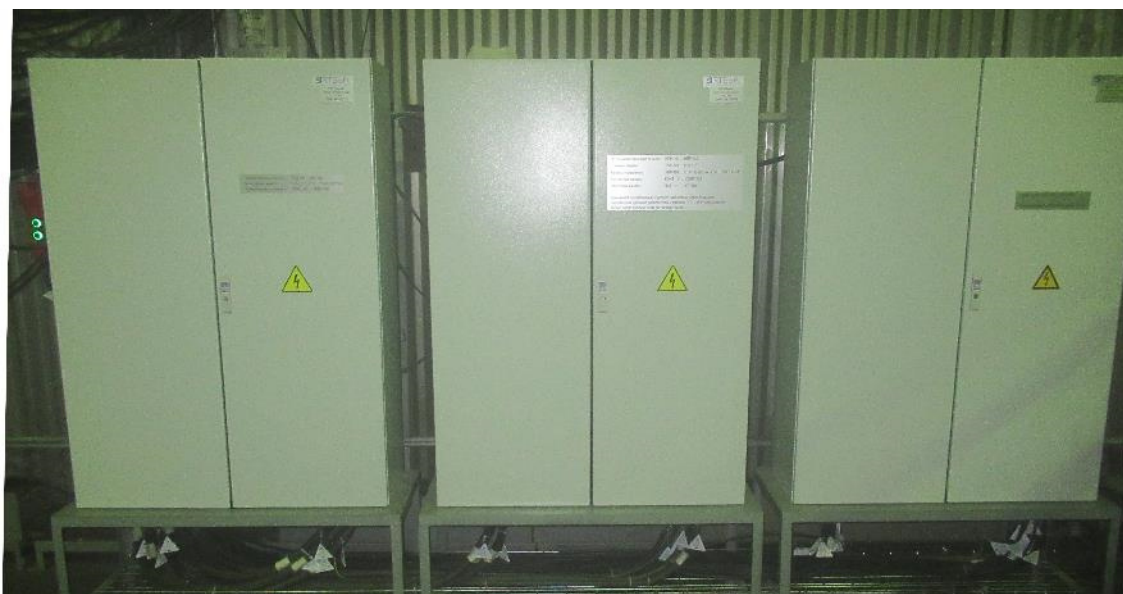
Рисунок 10 – Общий вид шкафов датчиков станда 112А ИВК Персей
