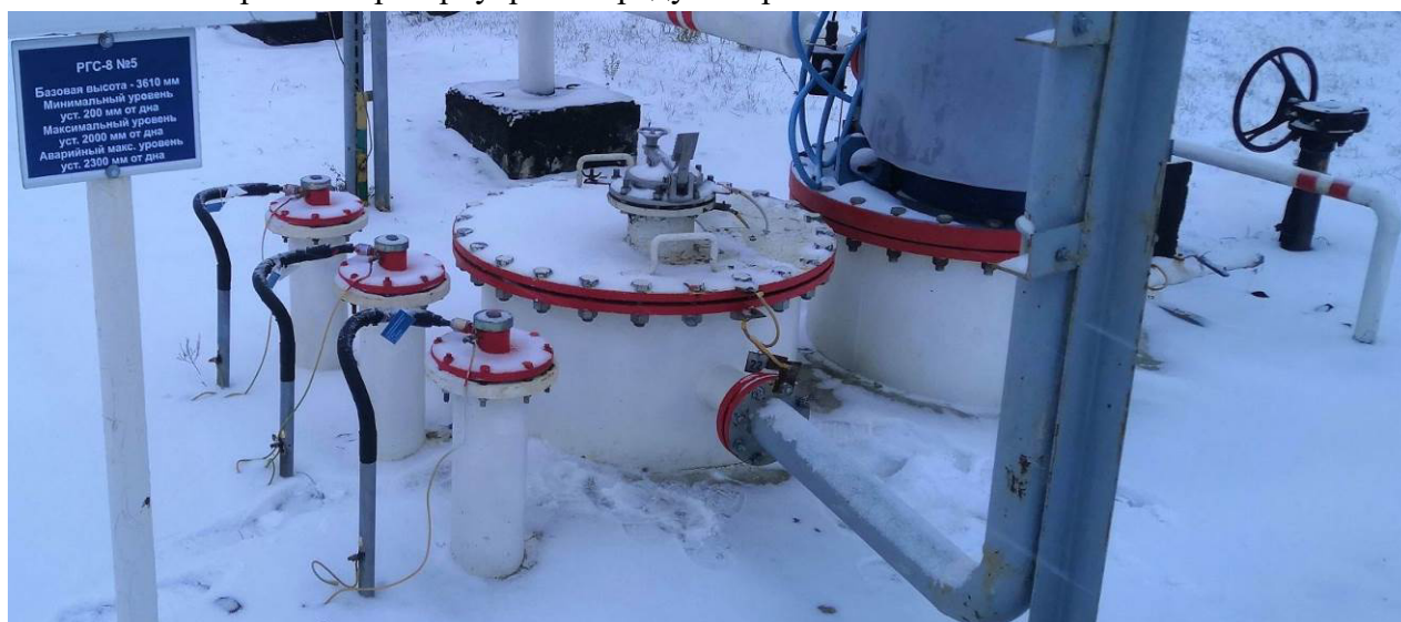
Рисунок 1 - Место нанесения заводского номера резервуара РГС-8
