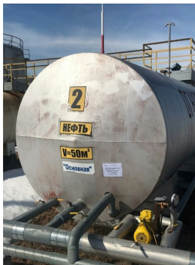
Рисунок 1 – Общий вид резервуаров РГС-50
