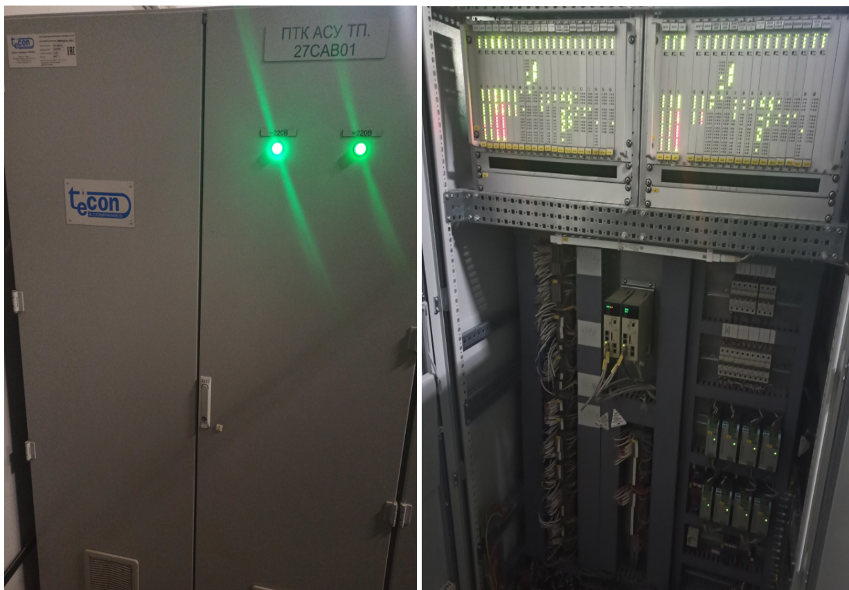
Рисунки 1, 2 – Общий вид электротехнического шкафа системы
