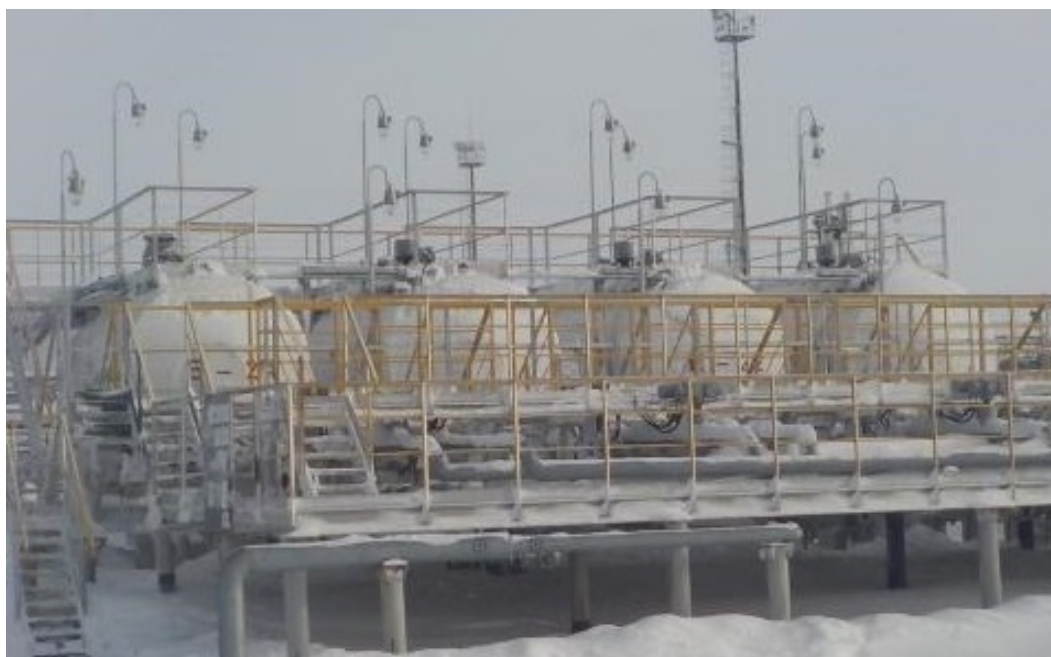
Рисунок 1 – Общий вид резервуаров РГС-25
