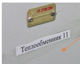
Вид части боковой панели шкафа
