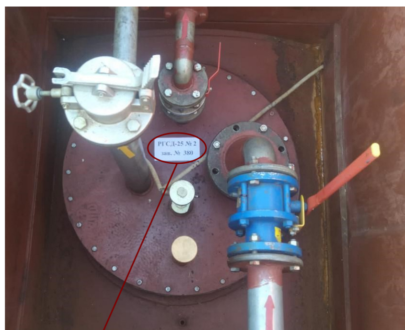
Рисунок 3 – Крышка люка резервуара РГСД-25 зав.№378
