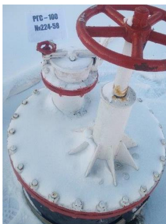
Рисунок 4 – Фотография горловины и заводского номера резервуара стального горизонтального цилиндрического РГС-100, заводской номер 224-58
