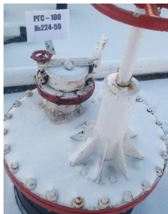
Рисунок 5 – Фотография горловины и заводского номера резервуара стального горизонтального цилиндрического РГС-100, заводской номер 224-59
