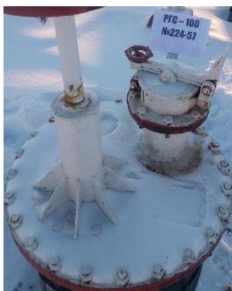
Рисунок 3 – Фотография горловины и заводского номера резервуара стального горизонтального цилиндрического РГС-100, заводской номер 224-57
