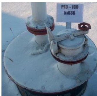
Рисунок 2 – Фотография горловины и заводского номера резервуара стального горизонтального цилиндрического РГС-100, заводской номер 036
