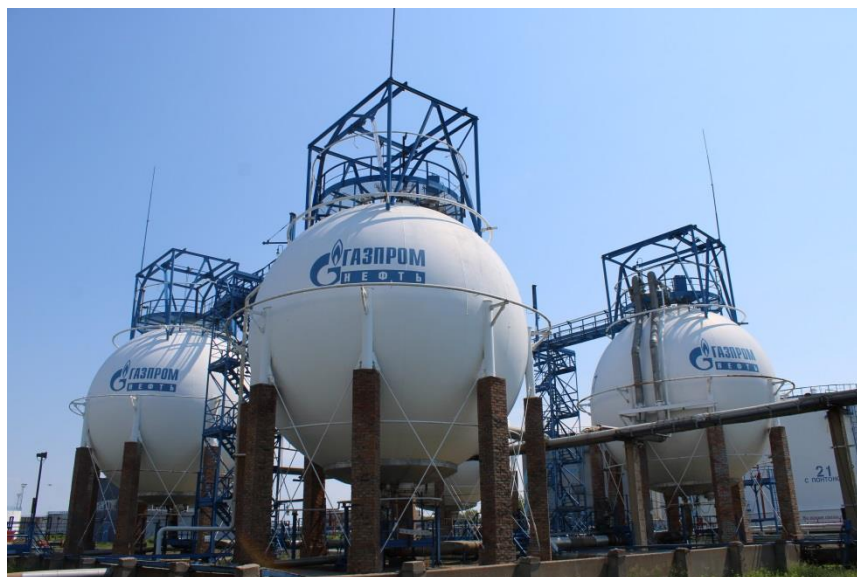
Рисунок 1 – Общий вид резервуаров стальных сферических (шаровых) РШС-600
