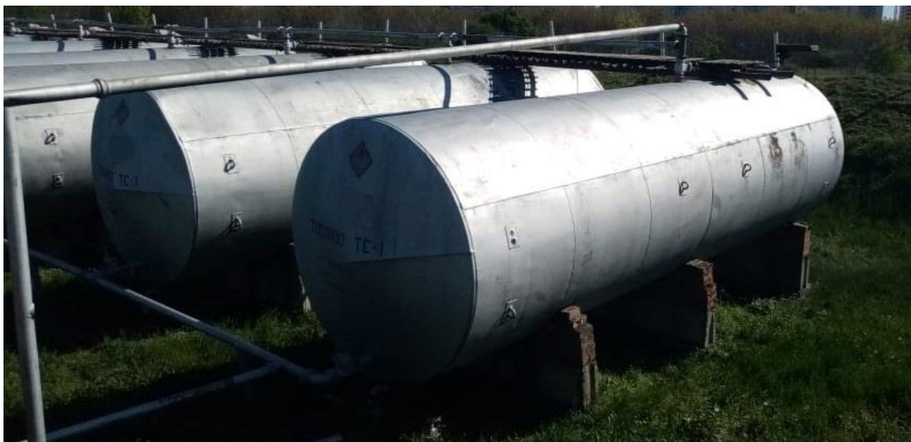
Рисунок 1 – Общий вид резервуаров РГС-50
