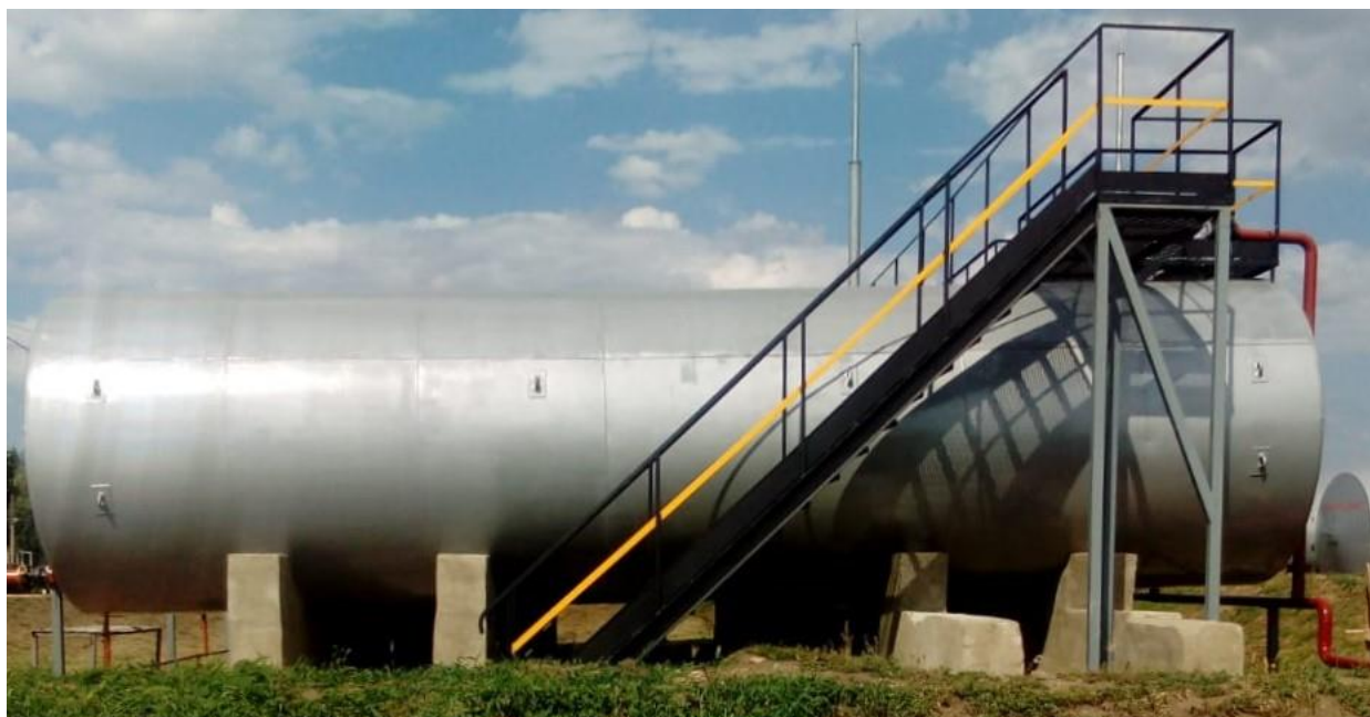
Рисунок 1 – Общий вид резервуаров РГС-60
