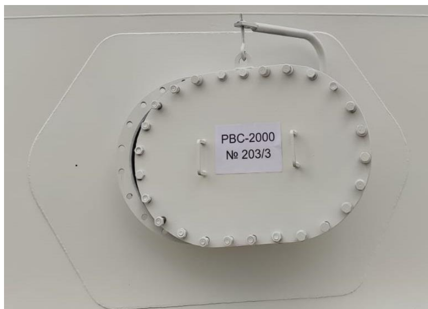
Рисунок 4 – Общий вид резервуаров PVC-2000
