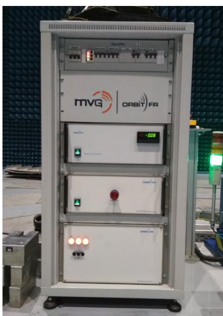
Рисунок 15 – Общий вид стойки контроллера опорно-поворотного устройства
