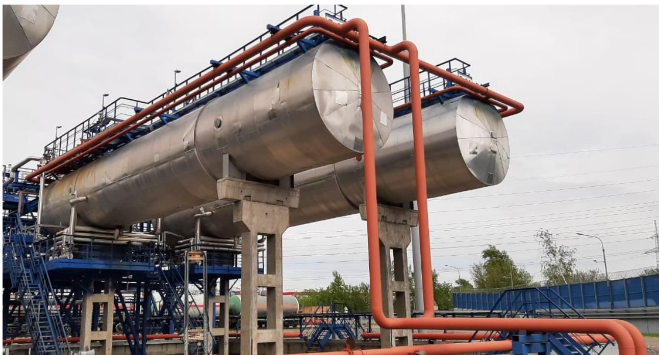
Рисунок 2 – Общий вид резервуаров РГС-200
