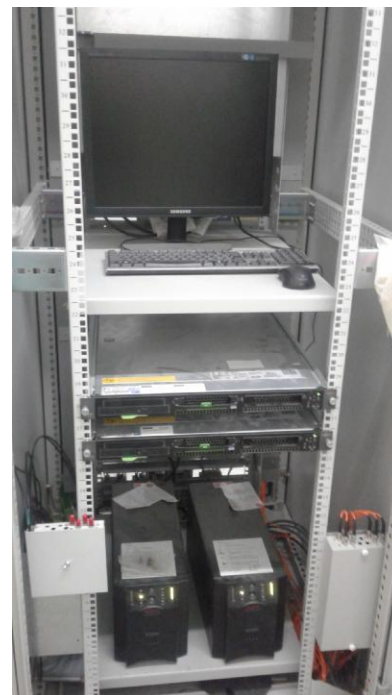
Рисунок 3 - Общий вид шкаф инженерной станции и сервера
