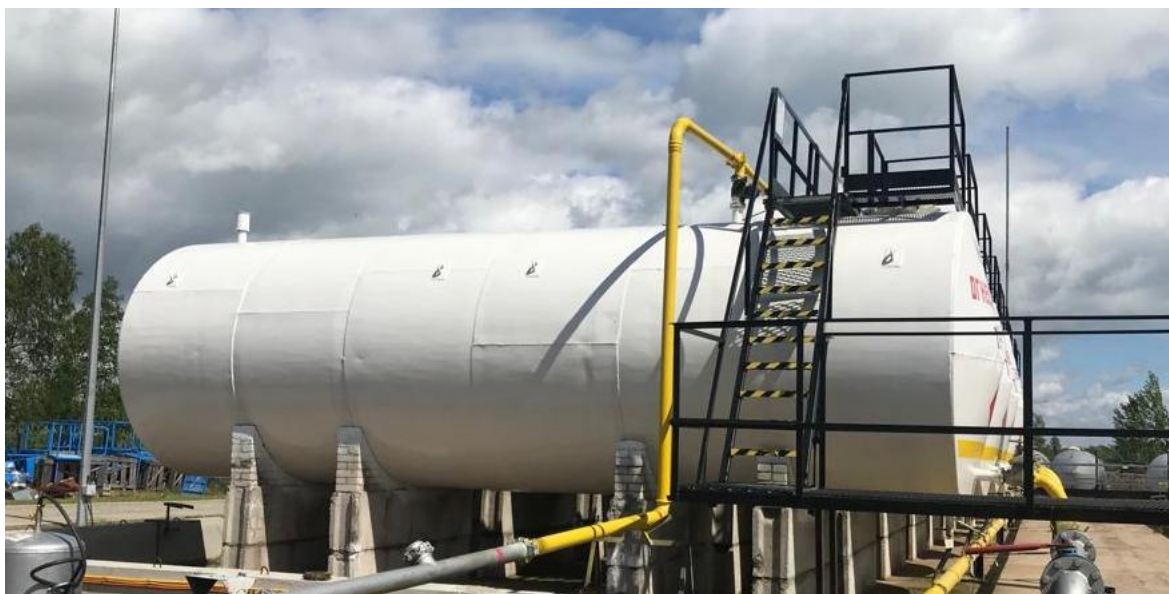
Рисунок 2 - Общий вид резервуаров стальных горизонтальных цилиндрических РГС-50
