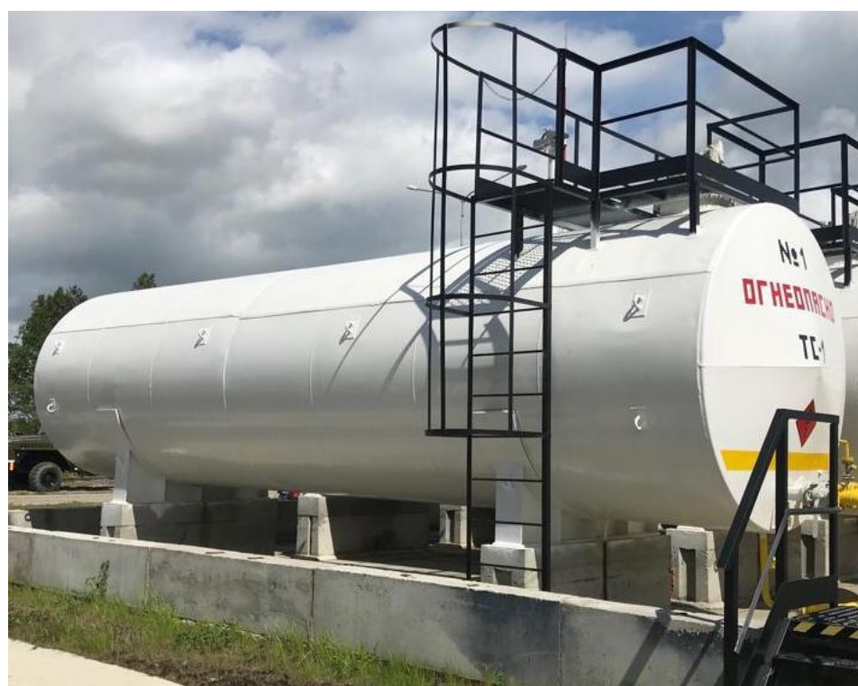
Рисунок 3 - Общий вид резервуаров стальных горизонтальных цилиндрических РГС-60
