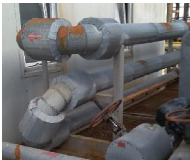
Рисунок 1 – Общий вид установки трубопоршневой поверочной стационарной «Прувер С-100-6,3», заводской № 16
