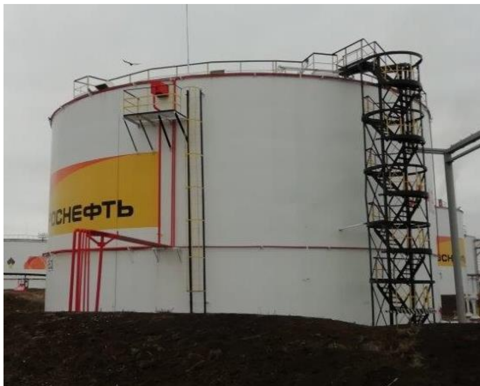
Рисунок 6 – Общий вид резервуаров стальных вертикальных цилиндрических РВСП-5000
