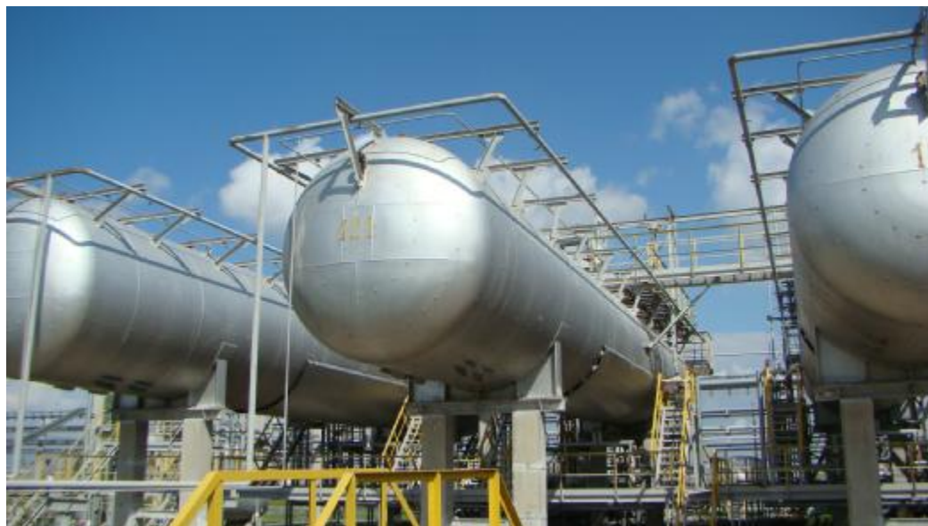
Рисунок 1 - Общий вид резервуаров стальных горизонтальных цилиндрических РГС-200
