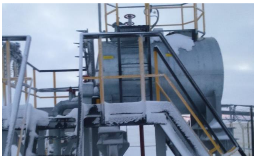
Рисунок 1 – Общий вид резервуаров стальных горизонтальных цилиндрических РГС-3
