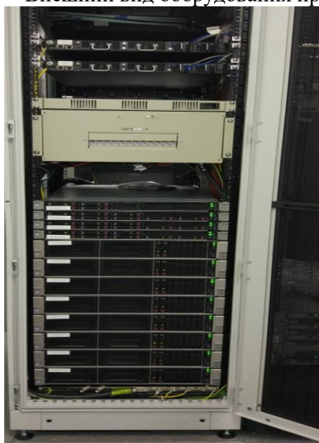
Рисунок 1 – Внешний вид оборудования с открытой дверью
