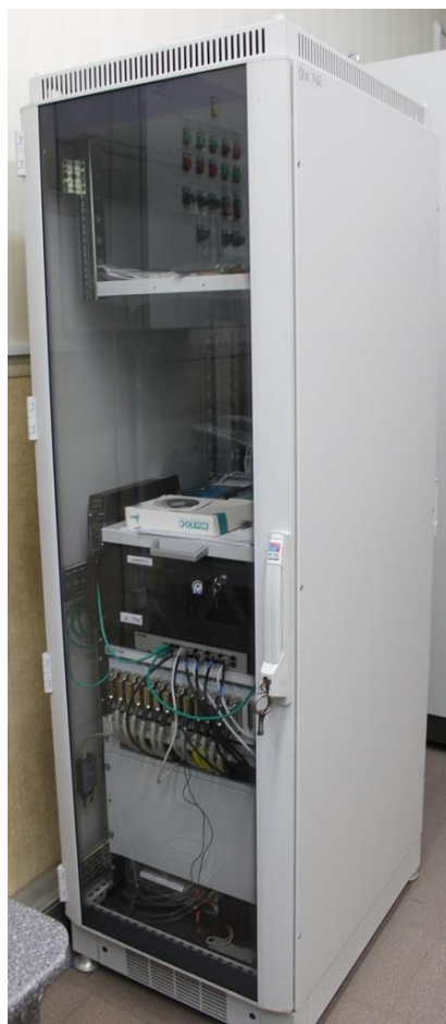
Рисунок 2 – Общий вид приборной стойки
