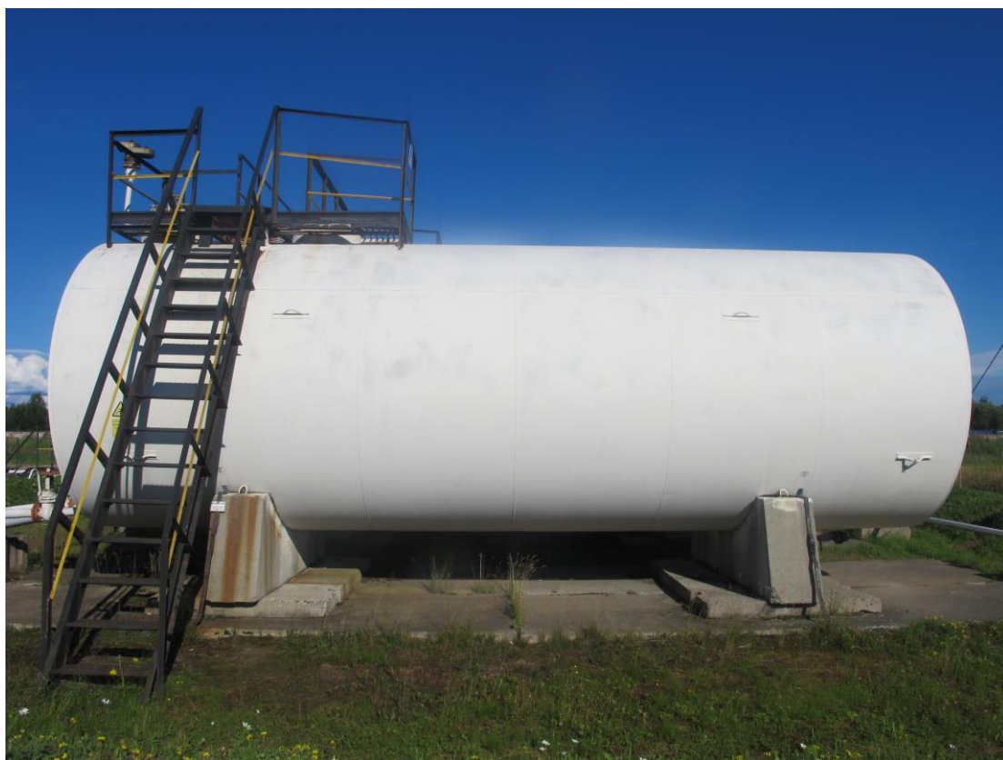
Рисунок 1 – Общий вид резервуаров стальных горизонтальных цилиндрических РГС-75
