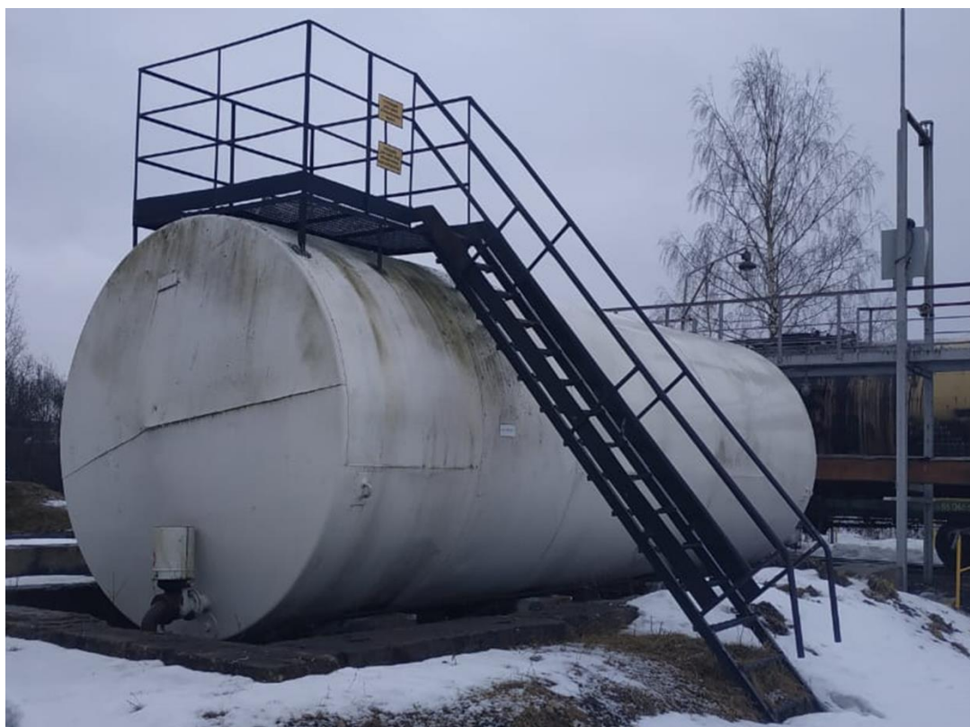
Рисунок 1 – Общий вид резервуара стального горизонтального цилиндрического
