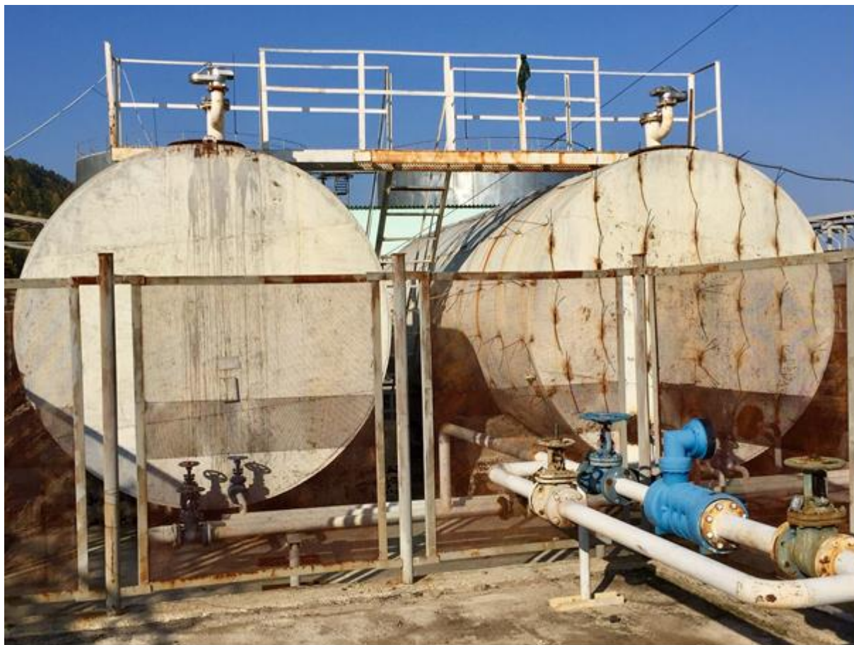
Рисунок 1 – Общий вид резервуаров горизонтальных стальных цилиндрических РГС-75
