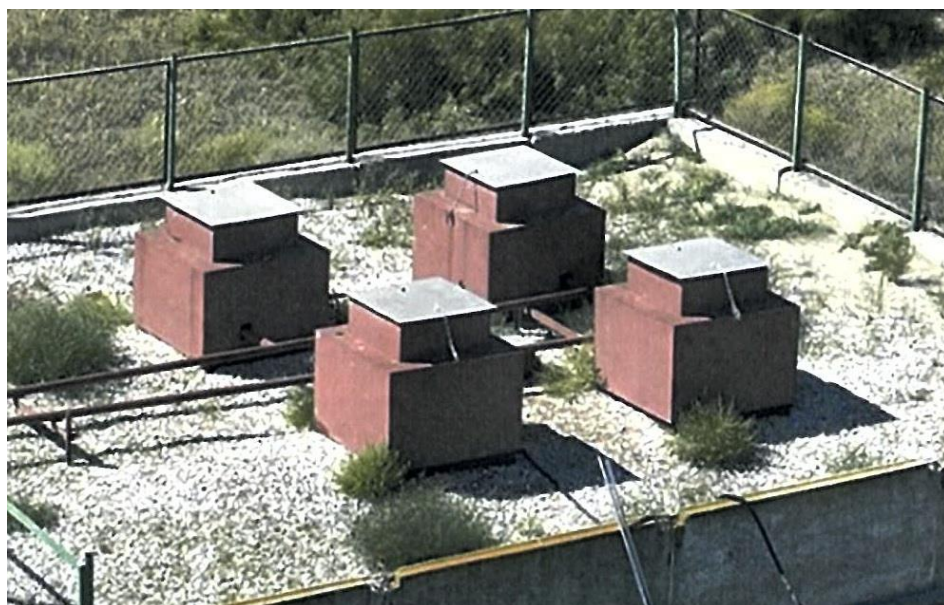
Рисунок 1 – Общий вид резервуаров РГС-25 зав.№№ 77, 78, 79, 80
