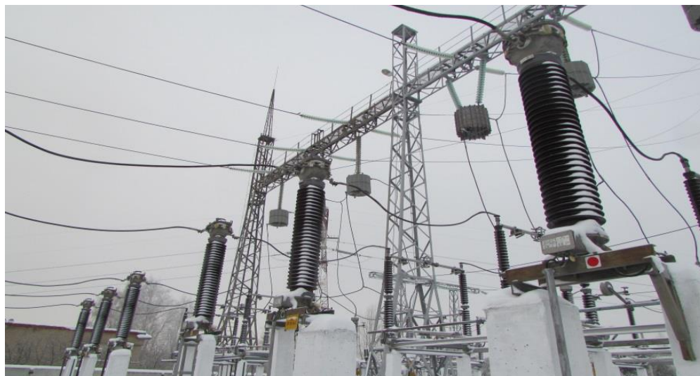
Рисунок 1 - Общий вид трансформаторов
