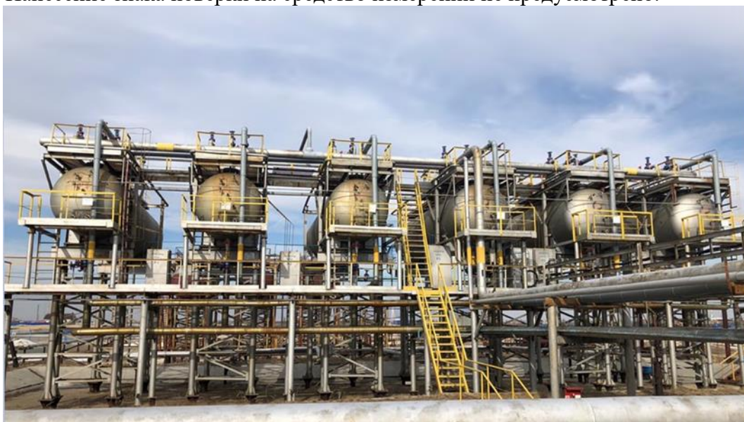
Рисунок 1 – Общий вид резервуаров РГС-50
