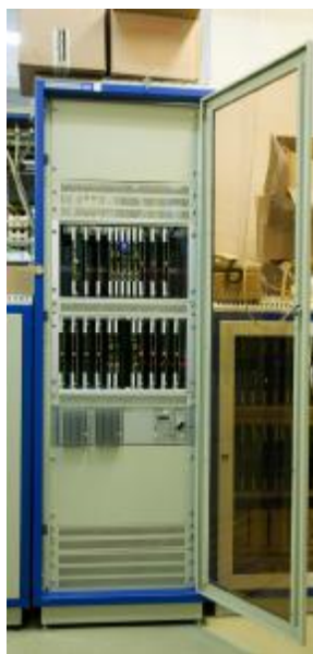
Рисунок 1 - Общий вид оборудования с открытой дверью шкафа
