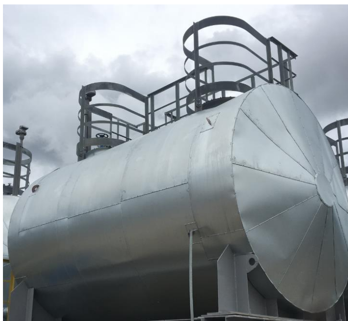
Рисунок 1 – Общий вид резервуаров РГС-25
