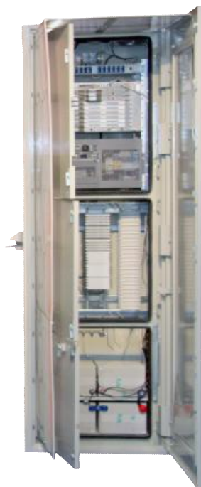
Рисунок 1 - Общий вид оборудования с открытой дверью шкафа
