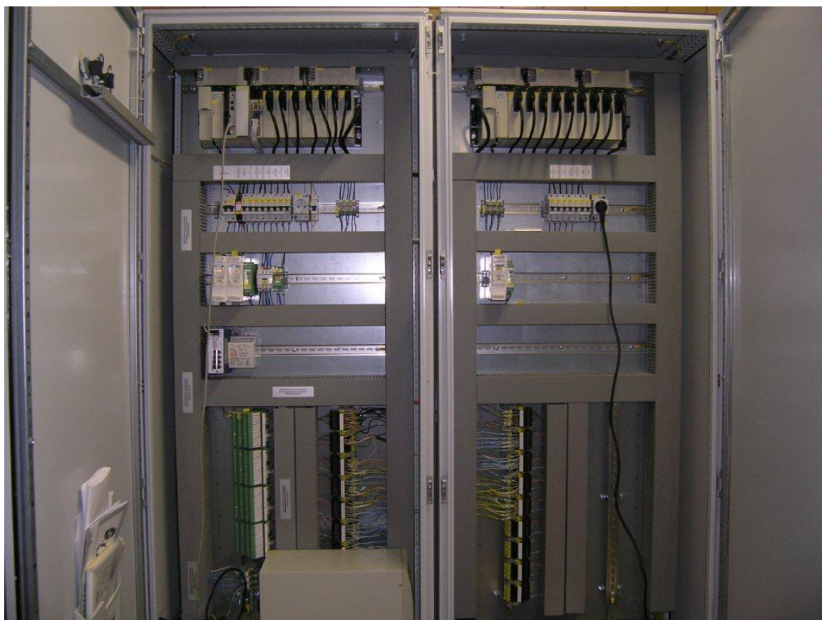
Рисунок 1 - Фотография шкафов с контроллерами и модулями ввода
