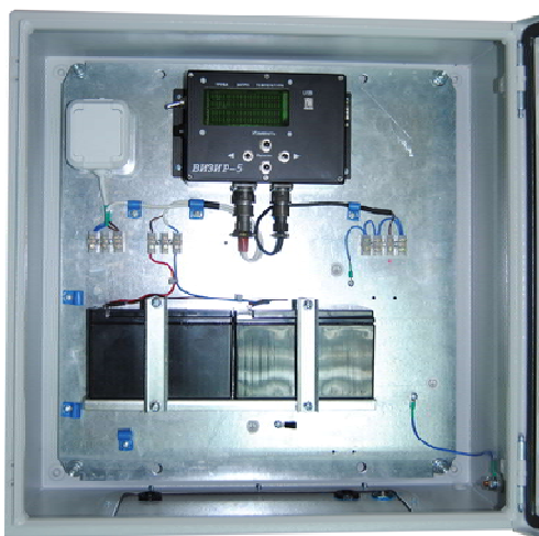
Рисунок 2 - Устьевого приемный бокс УПБ с блоком ВИЗИР-5
