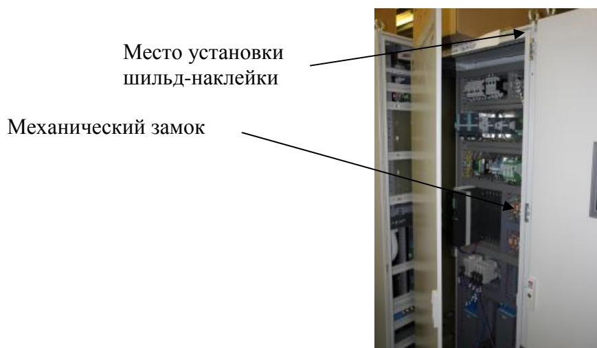
Рисунок 1 - Контроллер в приборном шкафу
