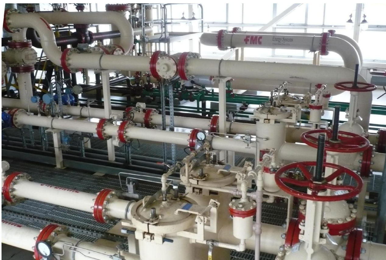
Рисунок 1 - Общий вид СИКН
