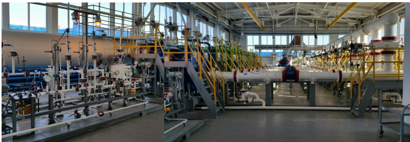
Рисунок 1 - Общий вид СИКН
