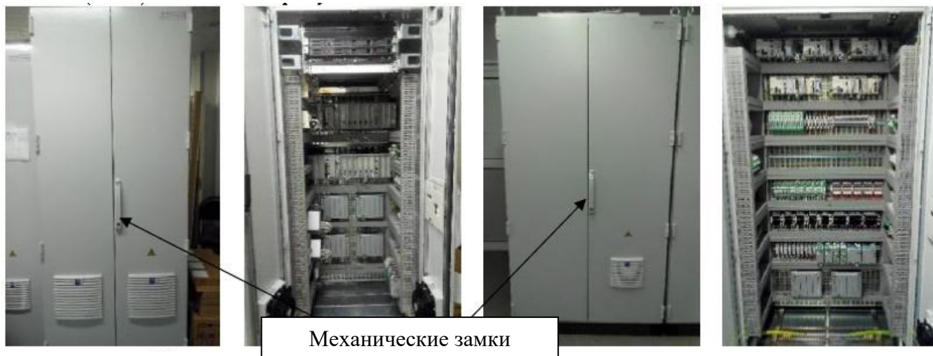
Рисунок 1 - Общий вид шкафов каналов измерительных ПТК МПСА «Шнейдер Электрик»
