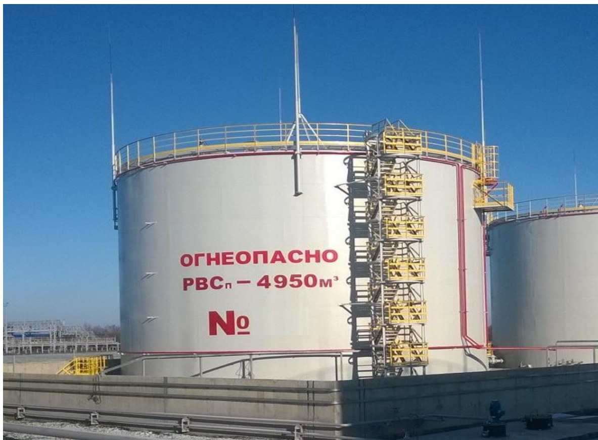
Рисунок 1 - Общий вид резервуаров вертикальных стальных РВСп-4950
