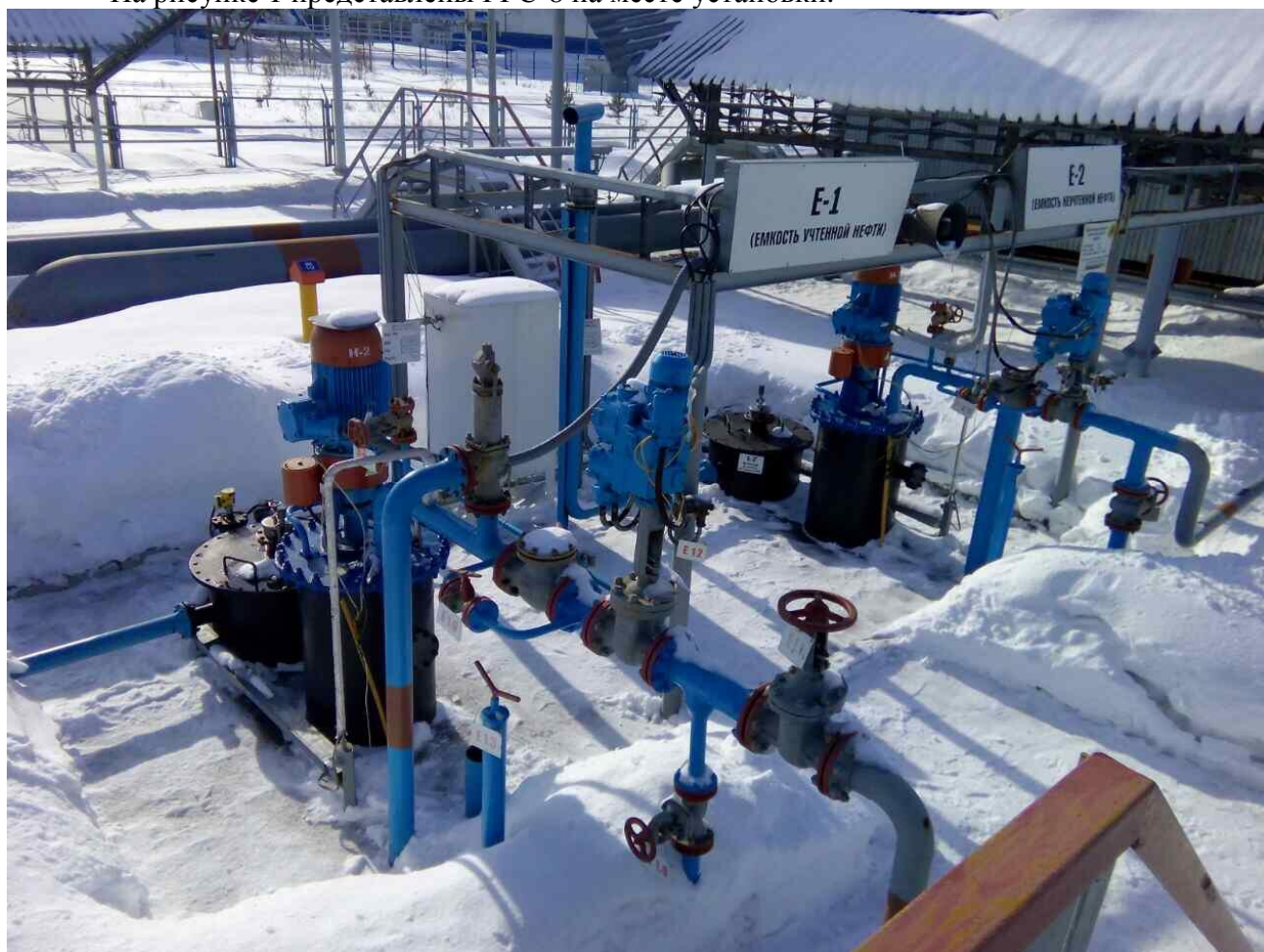
Рисунок 1 – РГС-8 с заводскими номерами Е-1, Е-2 на месте установки
