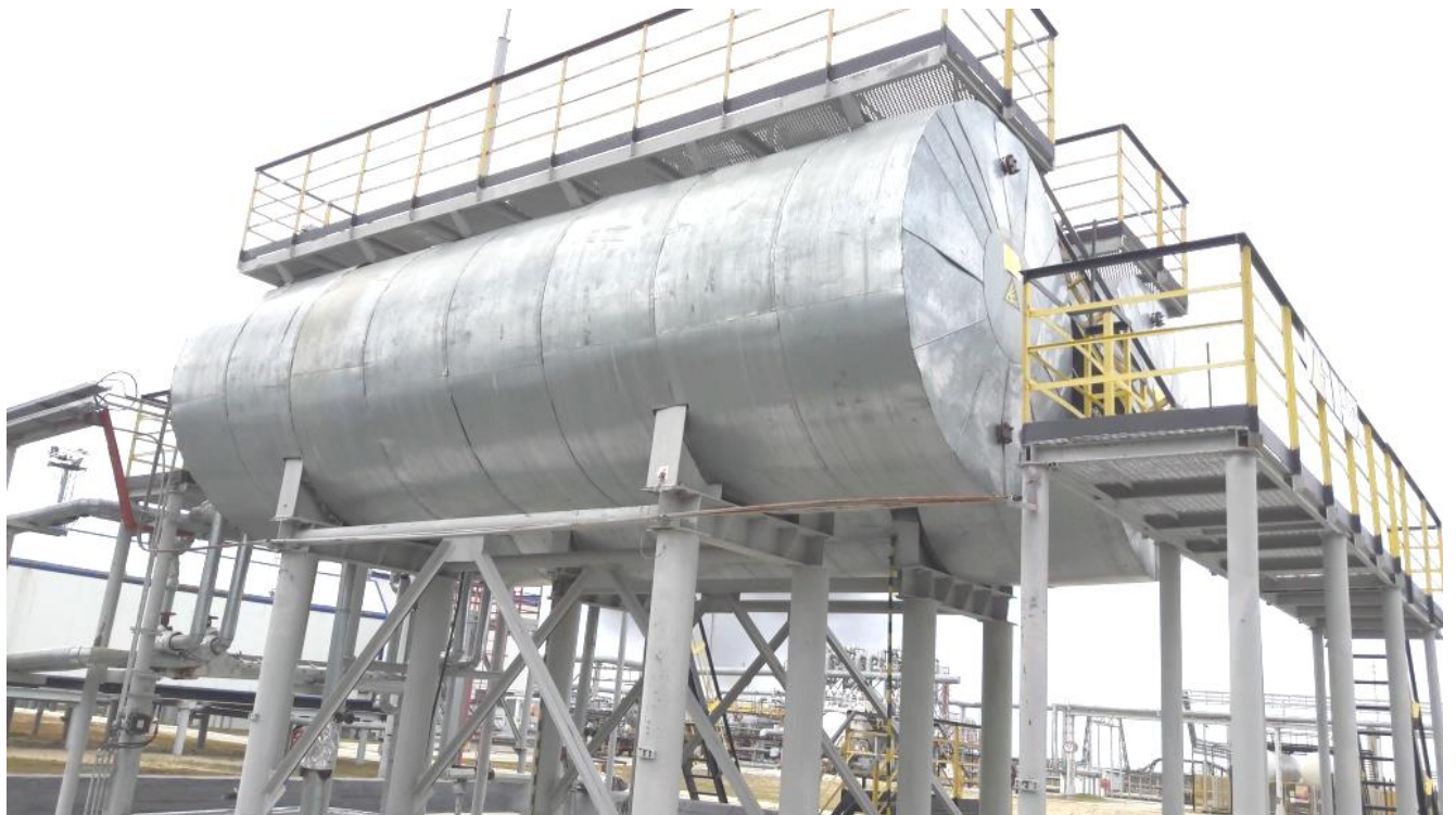
Рисунок 1 - Общий вид резервуаров стальных горизонтальных цилиндрических РГС-50
