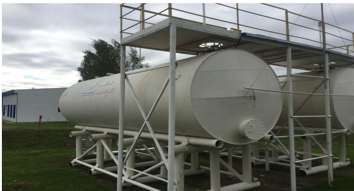
Рисунок 1 - Общий вид резервуаров стальных горизонтальных цилиндрических РГС-50
