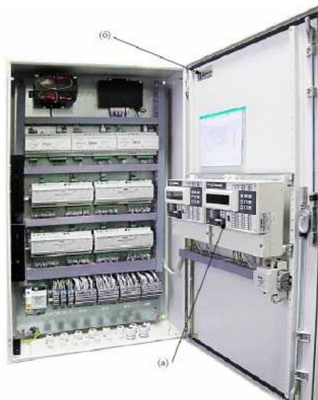
Рисунок 2 - Шкаф контроллера ПТК навесного исполнения
