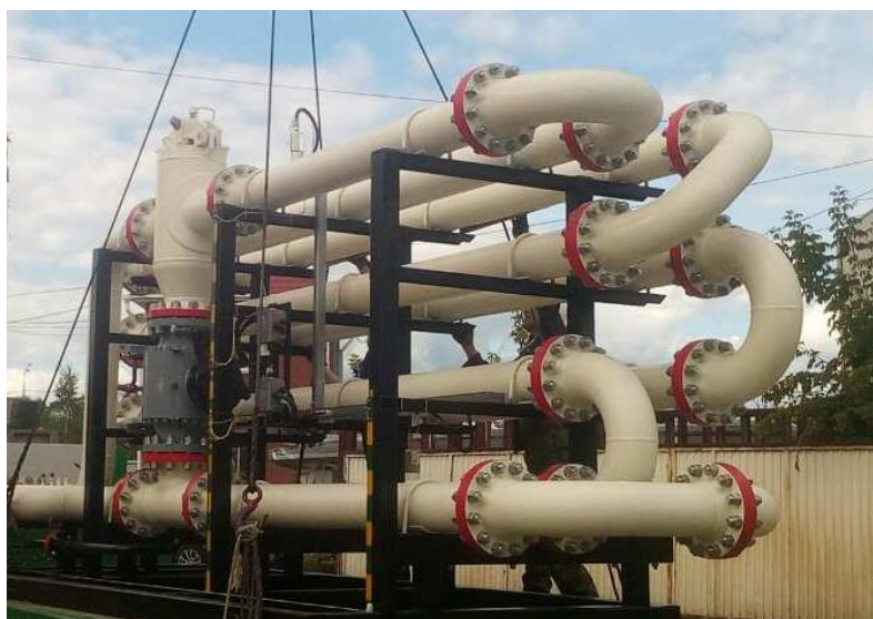
Рисунок 1 - Общий вид установок трубопоршневых поверочных ТПУ «Сапфир-Вектор-350»
