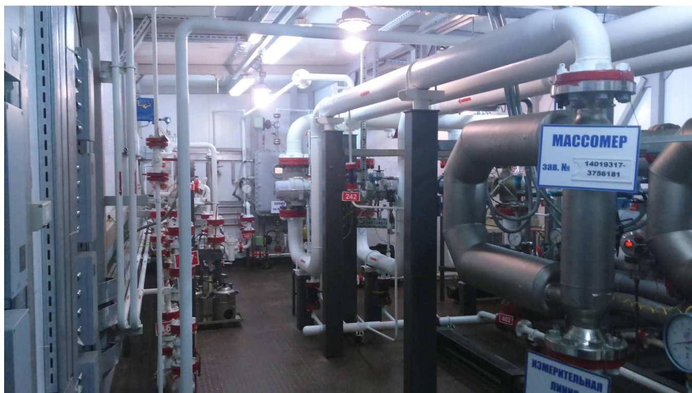
Рисунок 1 - Общий вид СИКН
