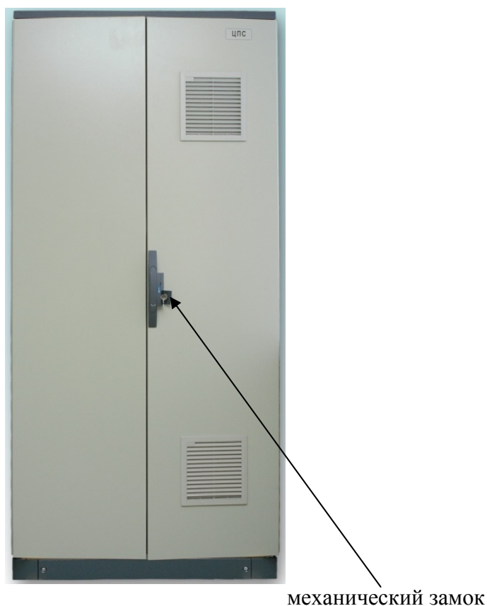
Рисунок 1 - Общий вид шкафов комплекса
