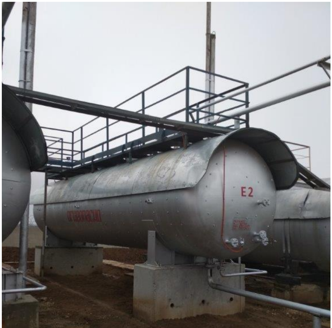
Рисунок 1 - Резервуар горизонтальный стальной РГС-50
