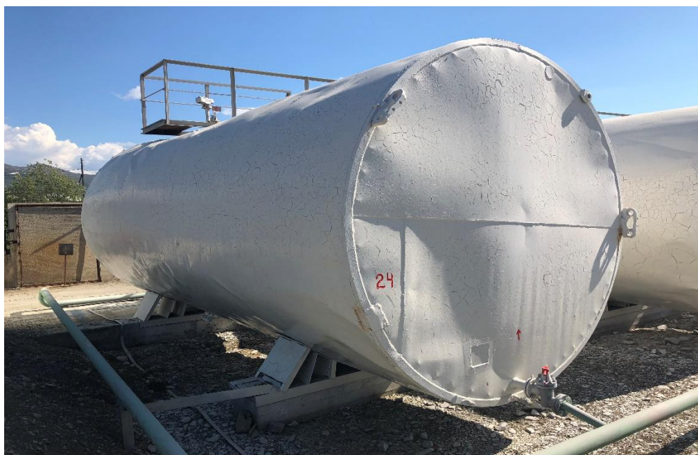
Рисунок 2 - Общий вид резервуаров стальных горизонтальных цилиндрических РГС-50
