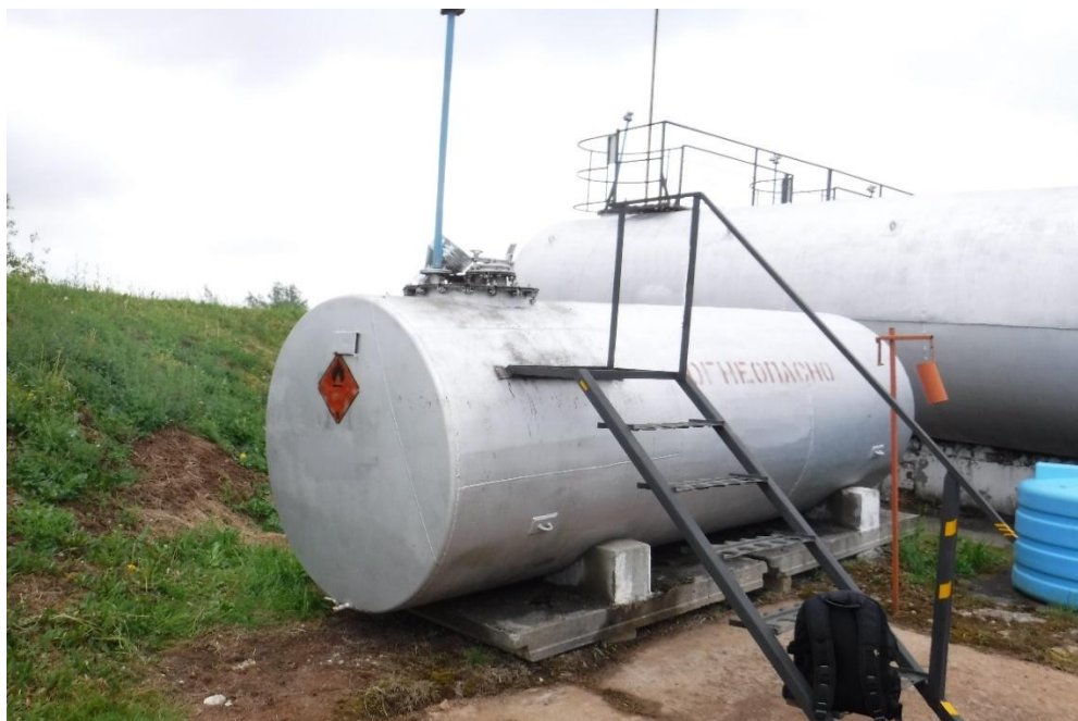
Рисунок 1 - Общий вид резервуаров стальных горизонтальных цилиндрических РГС-10
