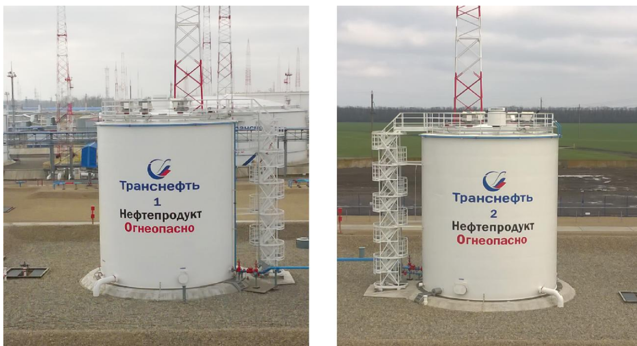
Рисунок 1 - Общий вид резервуаров стальных вертикальных цилиндрических РВС-1000 зав. №№ 1, 2
