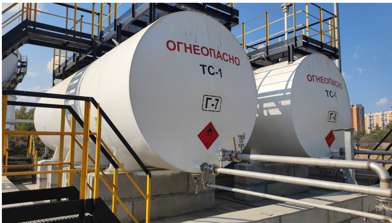
Рисунок 2 – Общий вид резервуаров РГ75
